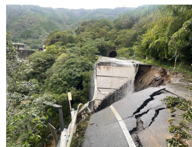
国道327号 道路損壊 もろつかそん (宮崎県諸塚村)
